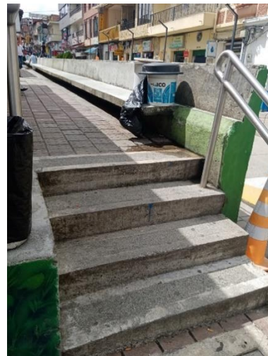
Fotografía No. 4. Sector con rejilla bajo la banca de concreto, está totalmente clausurada.
