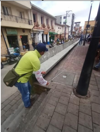
Fotografía No. 3. Sector con rejilla bajo la banca de concreto, está totalmente clausurada.
