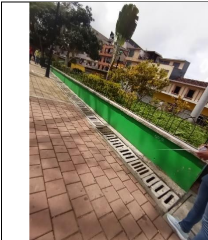
Fotografía 1. Rejilla del Parque principal Santa Bárbara, se evidencia la diferencia en la estandarización de las rejillas, la cuales presentan espacios, diferencia de tamaños y regularidad.
