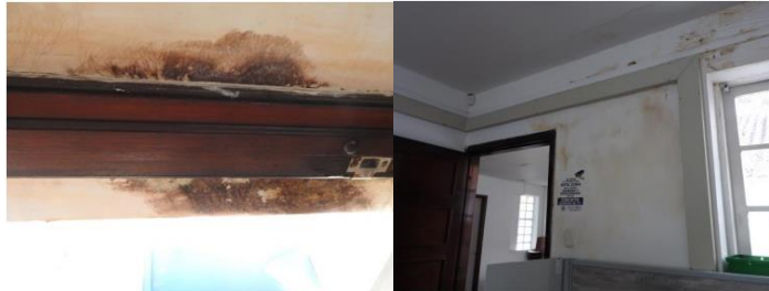
FIGURA 1 HUMEDAD PRESENTE EN MUROS INTERIORES ESPACIO 215 PARA USO DE OFICINAS.
