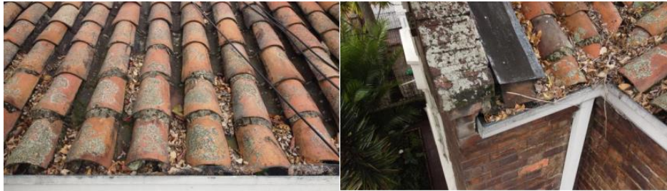
FIGURA 7 ESTADO ACTUAL DE LA CUBIERTA EN TEJA DE BARRO.
