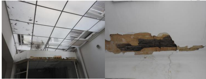
FIGURA 5 CIELORASO EN LÁMINA ACRÍLICA EN ESPACIO 115 USADO COMO AULA Y CIELORASO EN ESTERILLA DE GUADUA COLAPSADO. ESPACIO 202.
