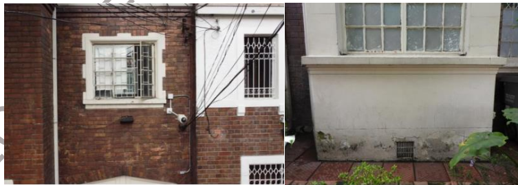
FIGURA 6 ESTADO ACTUAL DE LA FACHADA.
