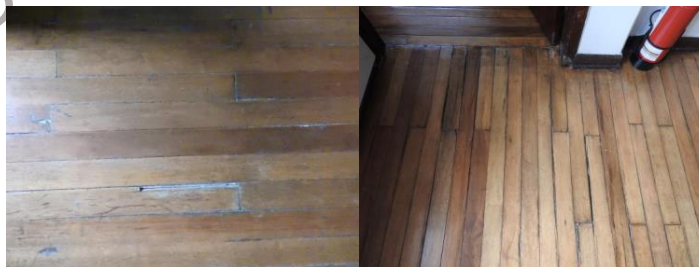
FIGURA 3 ESTADO ACTUAL DE PISOS EN ACABADO LISTONES DE MADERA.
