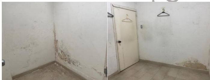
FIGURA 2 ESTADO GENERAL DE LOS PAÑETES DEL INMUEBLE. FOTOS TOMADAS EN EL ESPACIO 103 USADO COMO VESTIER DE LA VIGILANCIA.
