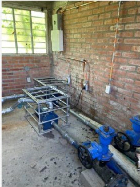
Equipos de bombeo
