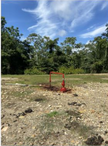
Fuente de Captación, pozo profundo T-357
