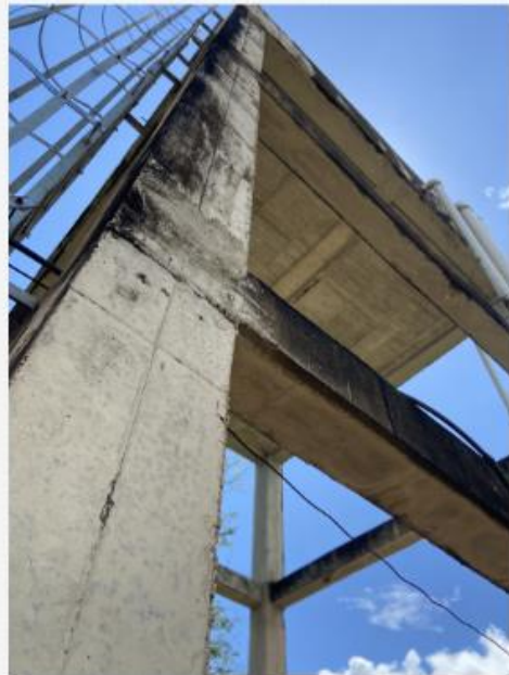
Tanque elevado de distribución
