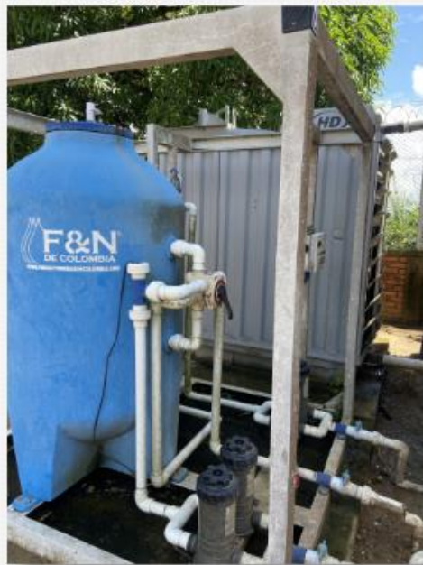
Sistema de tratamiento de agua potable
