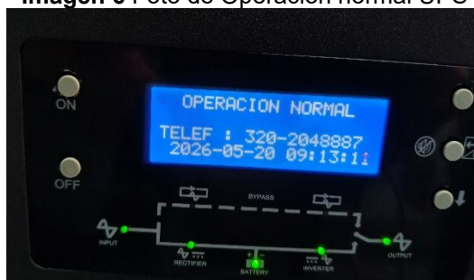
Imagen 6 Foto de Operación normal UPS
