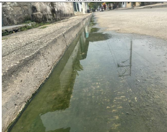
Imagen 6. Afectación ambiental por vertimiento de aguas servidas a la calle
