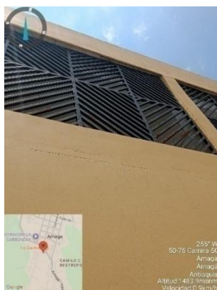
Imagen No. 17 Estructura metálica de fachada con presencia de óxido
