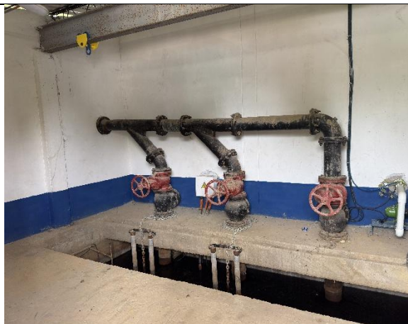
Imagen 2. Equipos de bombeo inutilizados
