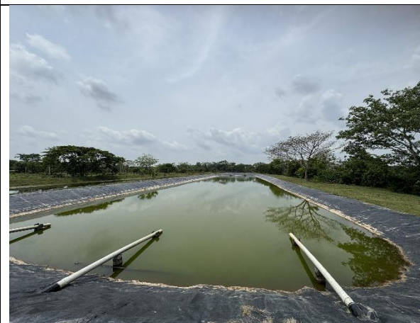
Imagen 5. Estado actual del sistema de tratamiento (Fase I) Sin funcionamiento
