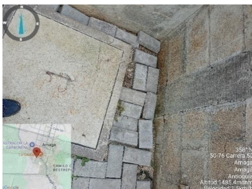
Imagen No. 7 Deficiencias en la Instalación de adoquín
