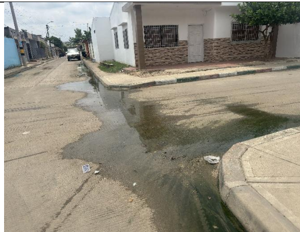
Imagen 8. Afectación ambiental por vertimiento de aguas servidas a la calle
