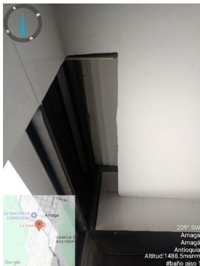
Imagen No. 14 Cielo raso con acabado incompleto
