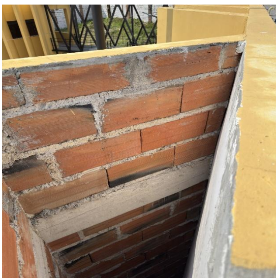
Imagen No. 15 Remate superior de fachada, donde se evidencia la exposición directa de la mampostería y la ausencia de viga de corona
