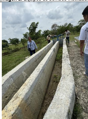
Imagen 4. Estado actual del sistema de tratamiento (Fase I) Sin funcionamiento
