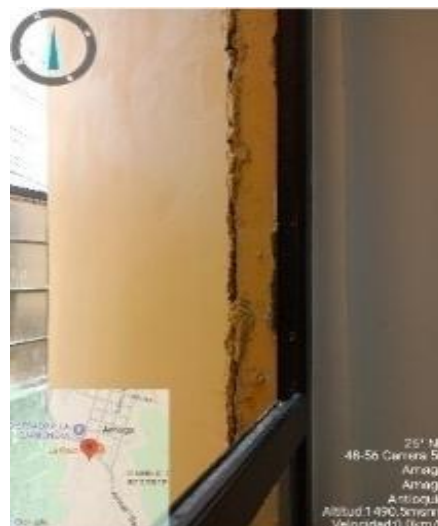
Imagen No. 18 Dilatación vertical del parosol
