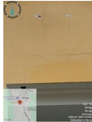
Imagen No. 20 Fachada con presencia grietas y desprendimiento de pintura
