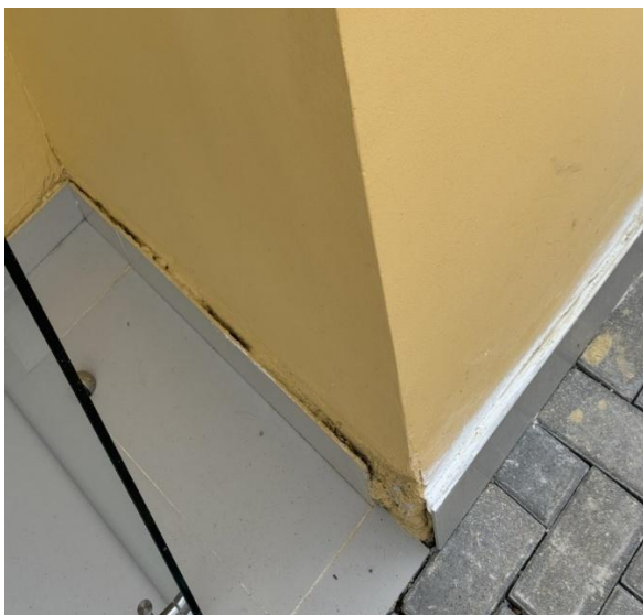
Imagen No. 5 Deficiencias en la instalación de Guarda escoba (Pegante aplicado de manera irregular)
