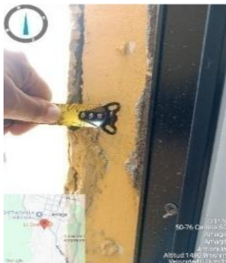
Imagen No. 17 Dilatación vertical del parosol (1cm)
