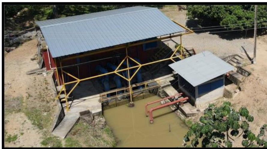
Figura 5. Estación Bombeo No 2.
