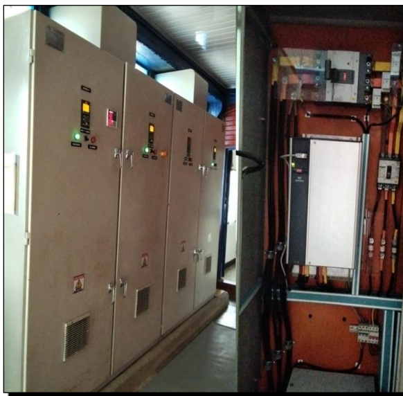
Ilustración 2. Tableros de operación, arrancador y variador de velocidad, de estación de rebombeo "Base 2". FUENTE: Asociación usuarios Distrito Adecuación Tierras de Mediana Escala de "Asojuncal", 2024.
