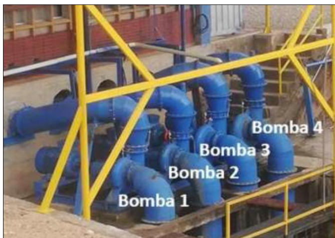
Ilustración 3. Unidades de Bombeo de la Estación de Bombeo N° 2 FUENTE: Asociación usuarios Distrito Adecuación Tierras de Mediana Escala de "Asojuncal", 2024.
