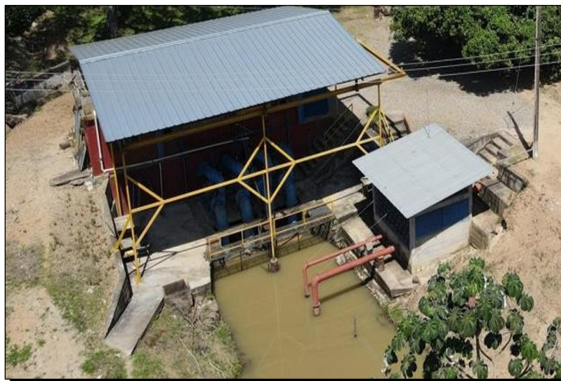
Ilustración 1. Estación de bombeo No 2.
