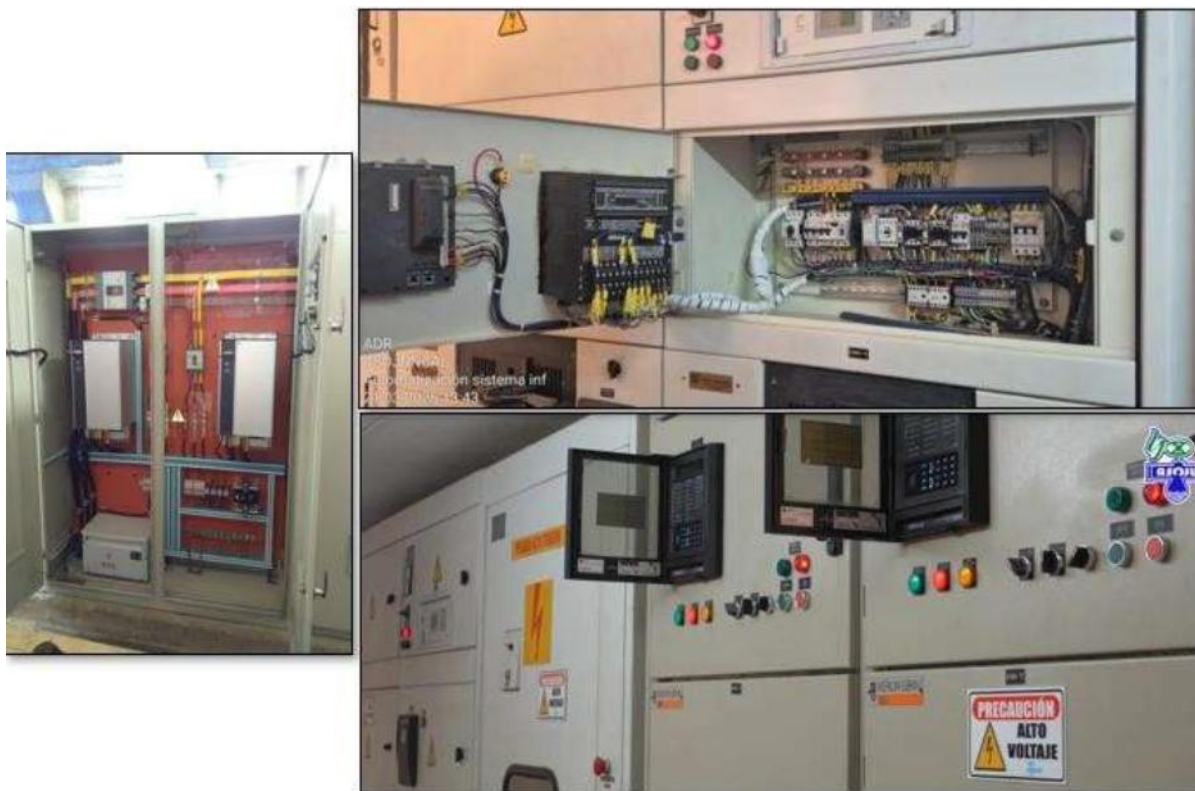
Ilustración 24. Arranques de la unidad de bombeo de la estación principal y rebombeo.
