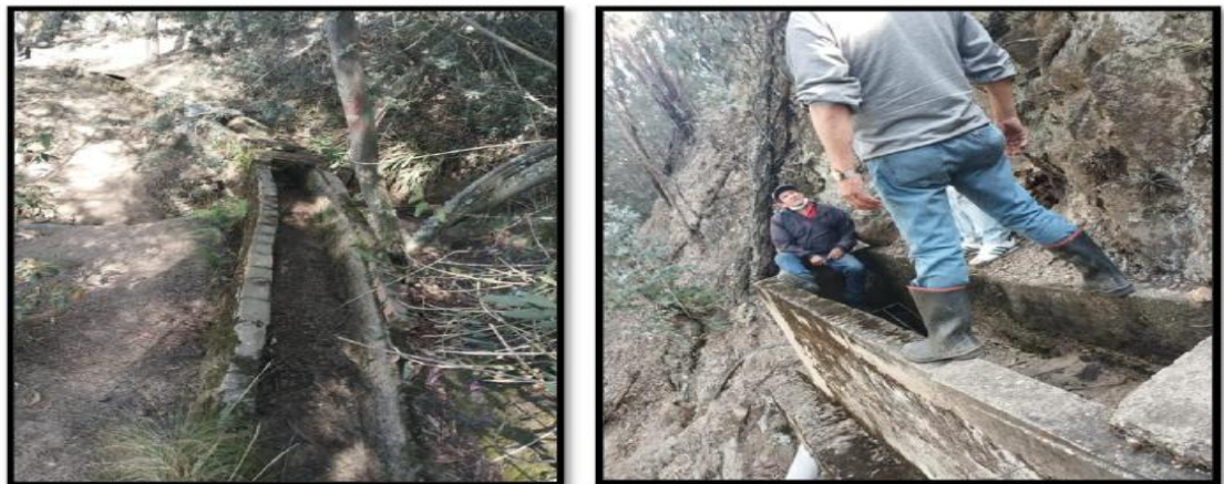
Imagen: estado de los canales abiertos
