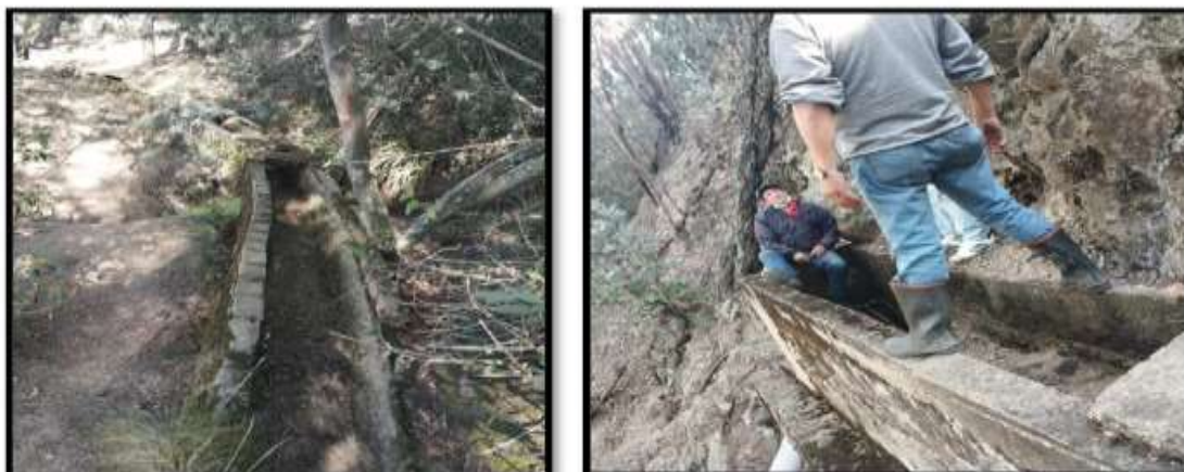
Imagen: estado de los canales abiertos
