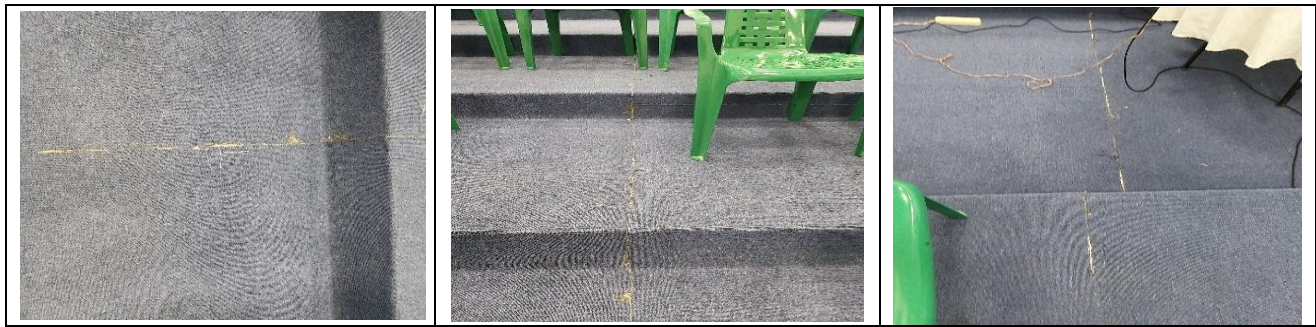
Zonas del manto edil desprendido y/o deteriorado
