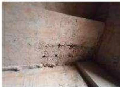
Fotografía No.2: Viga de concreto entre el Eje 4, Eje A a Eje C, se evidencia la presencia de hormiguo en la columna y acero expuesto, por falta de vibrado.
