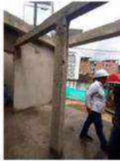
Fotografía No. 1. Columneta de oficina. Hormigueo y pérdida de material de concreto. Las dimensiones son de 12x19 cm y 2.2 m d altura.
