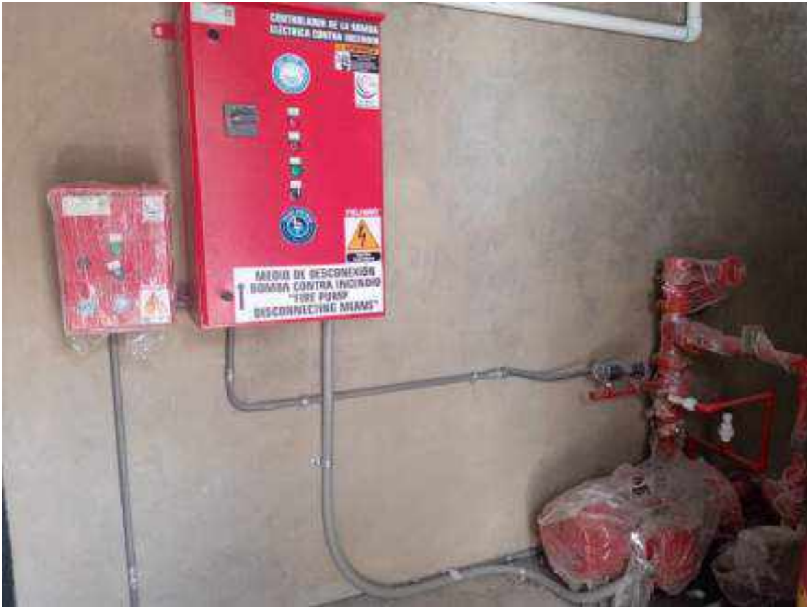
Imagen 17. Equipo de bombeo y tablero instalado, nótese que después de la válvula, no hay tubería conectada.
