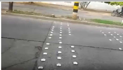
Descripción: Carrera 12, estoperoles metálicos en regular estado
